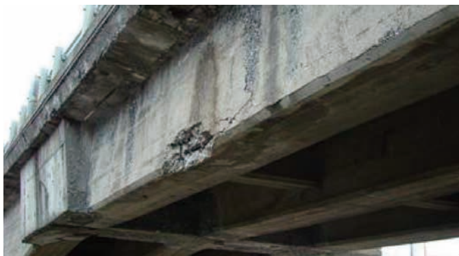
コンクリート橋の損傷例
