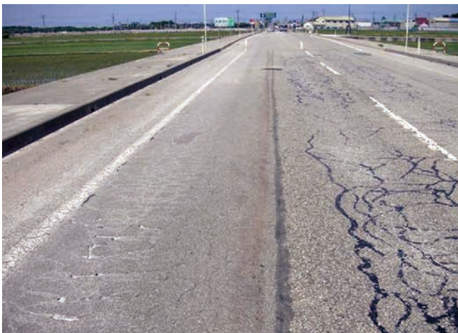
亀甲状に発達したひび割れ路面（舗装）
