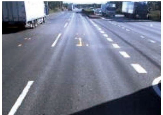
路面の凹み（わだち掘れ）が深くなった路面（舗装）
