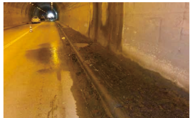
トンネルの損傷例
