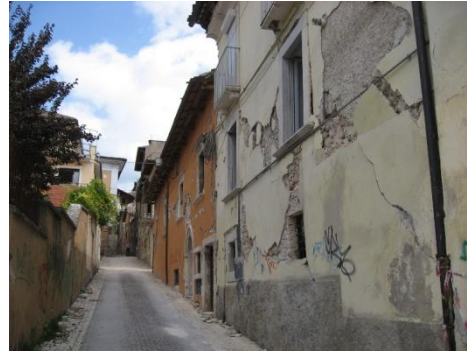
図10 被害を受けた住宅街
