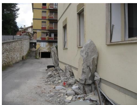
図2 1階駐車場部分がつぶれたマンション
