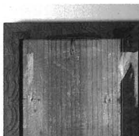
写真2.8.6 段差とテープ糊跡
