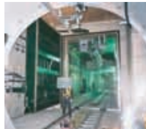
防水扉(線路部)
