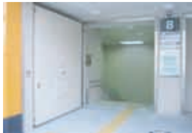
止水扉(出入口地上)
