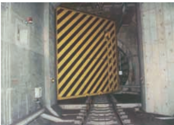
図-4 トンネル内防水ゲート
