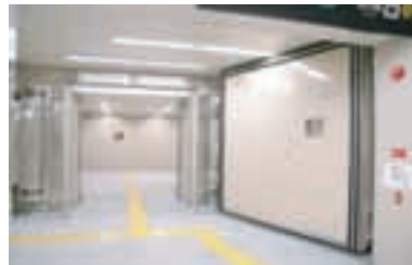
止水扉(出入口地下)
