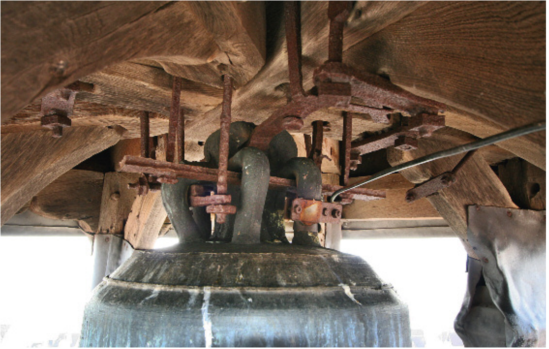
3 Die dritte Glocke (13. Jh.) mit schadhafter Aufhängung in der Laterne des Nordturmes.
