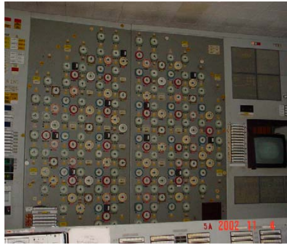
図10. 1号炉制御室の制御棒位置表示板
