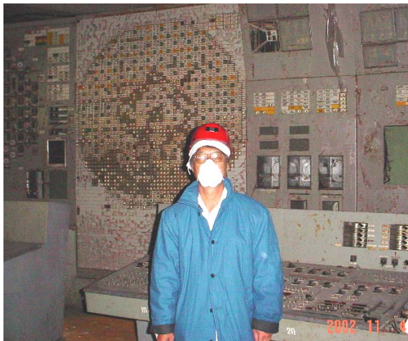
図9. 4号炉制御室(2002年11月)
