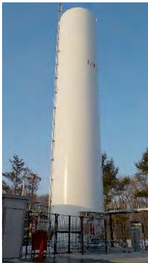
燃料転換によるCO 2 の削減 (別海工場 液化天然ガス貯蔵タンク)
