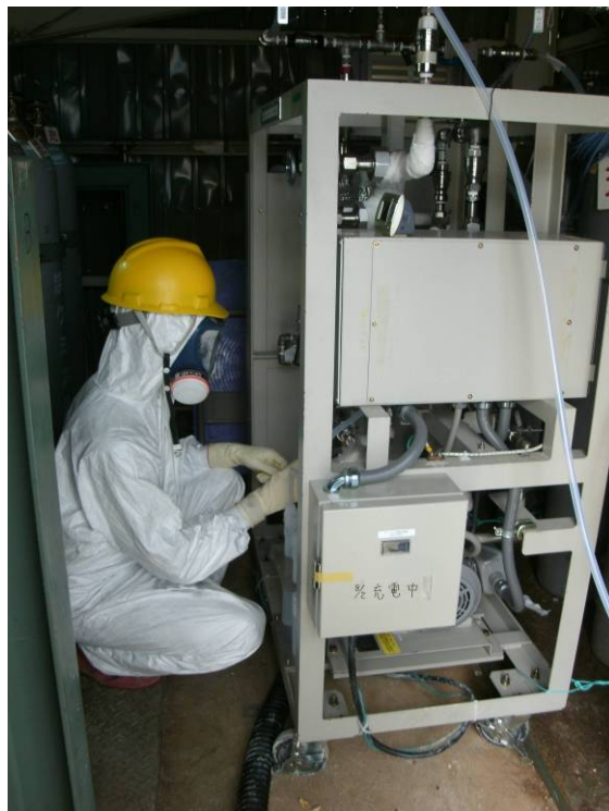
図 2 仮設 PCV ガスサンプリング装置 (2号8月、1号9月)
