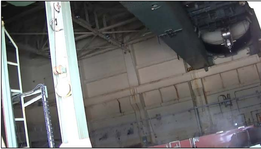
図5.2-2 9月17日撮影の5階原子炉直上部からの蒸気放出
