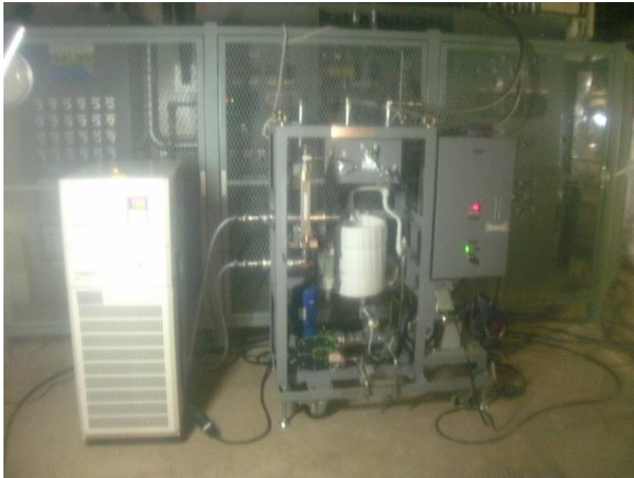
図 1 仮設 PCV ガスサンプリング装置 (1号7月)
