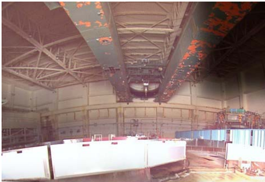
図5.2-3 10月20日撮影の5階原子炉直上部の状況 (蒸気放出無し)
