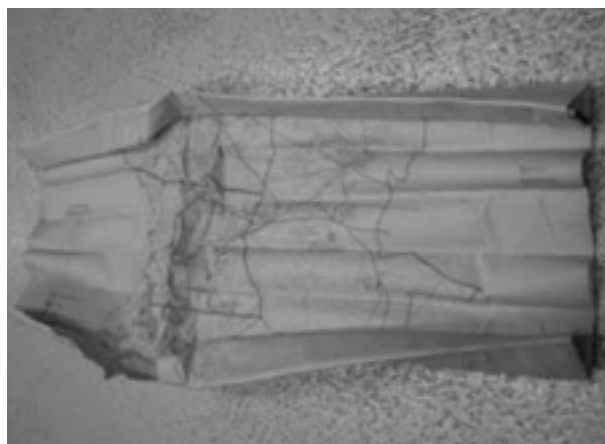
Schäden durch gerollte Lagerung.
