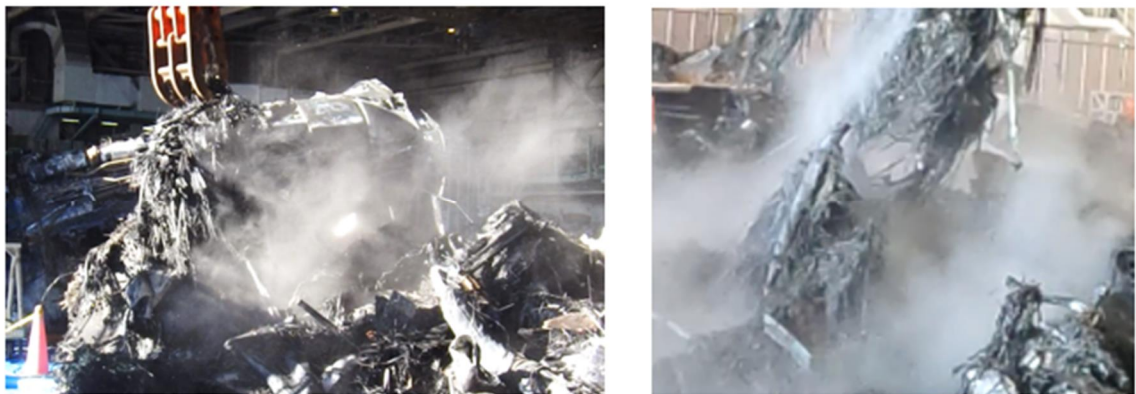
図3 4 - 2 CFRP焼損後の粉塵の状況
