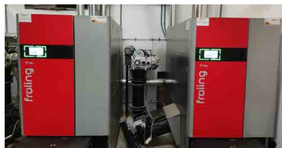
Caldera de biomasa del Parador de Cervera de Pisuerga
