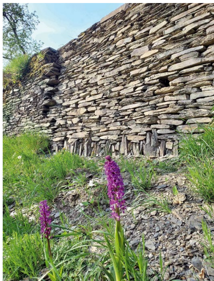
Mur de soutènement de terrasses en schiste restauré sur la colline du Deister à La Roche-en-Ardenne
