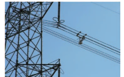
高压送電線上を走行するExpliner
