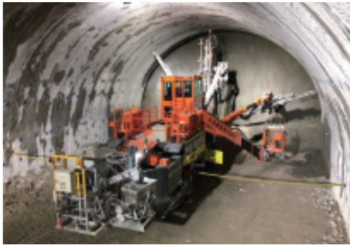
ロックボルト施工状況
