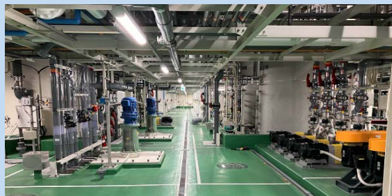
(廃水処理エリア)
