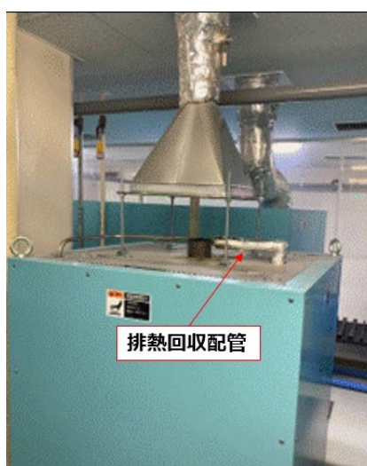
（電気炉の排熱利用設備）
