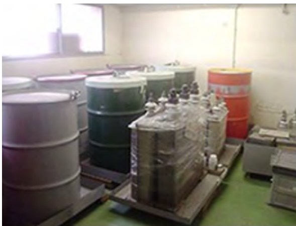
川崎本社における ポリ塩化ビフェニル保管倉庫内
