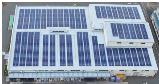
太陽光パネル (2017年12月稼働)
