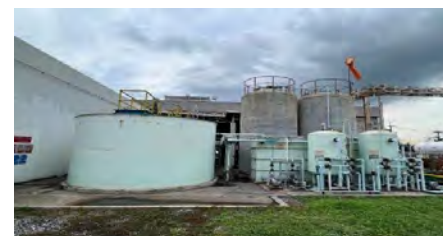
化学廃水処理設備 (FGT)
