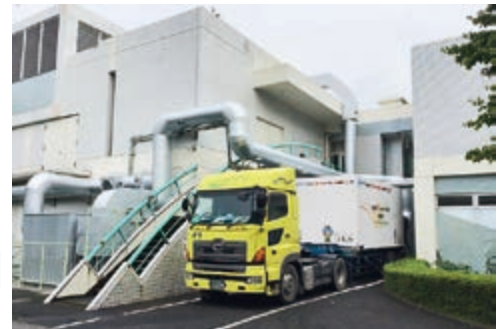
図2 熱利用サイト外観（羽村市スイミングセンター）
