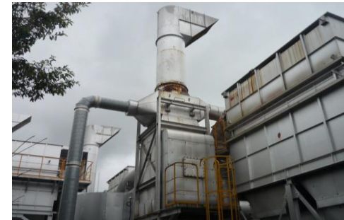
アイカハリマ工業(株)において、脱臭装置の排熱を回収して乾燥工程に利用することで蒸気使用量を削減しました。
