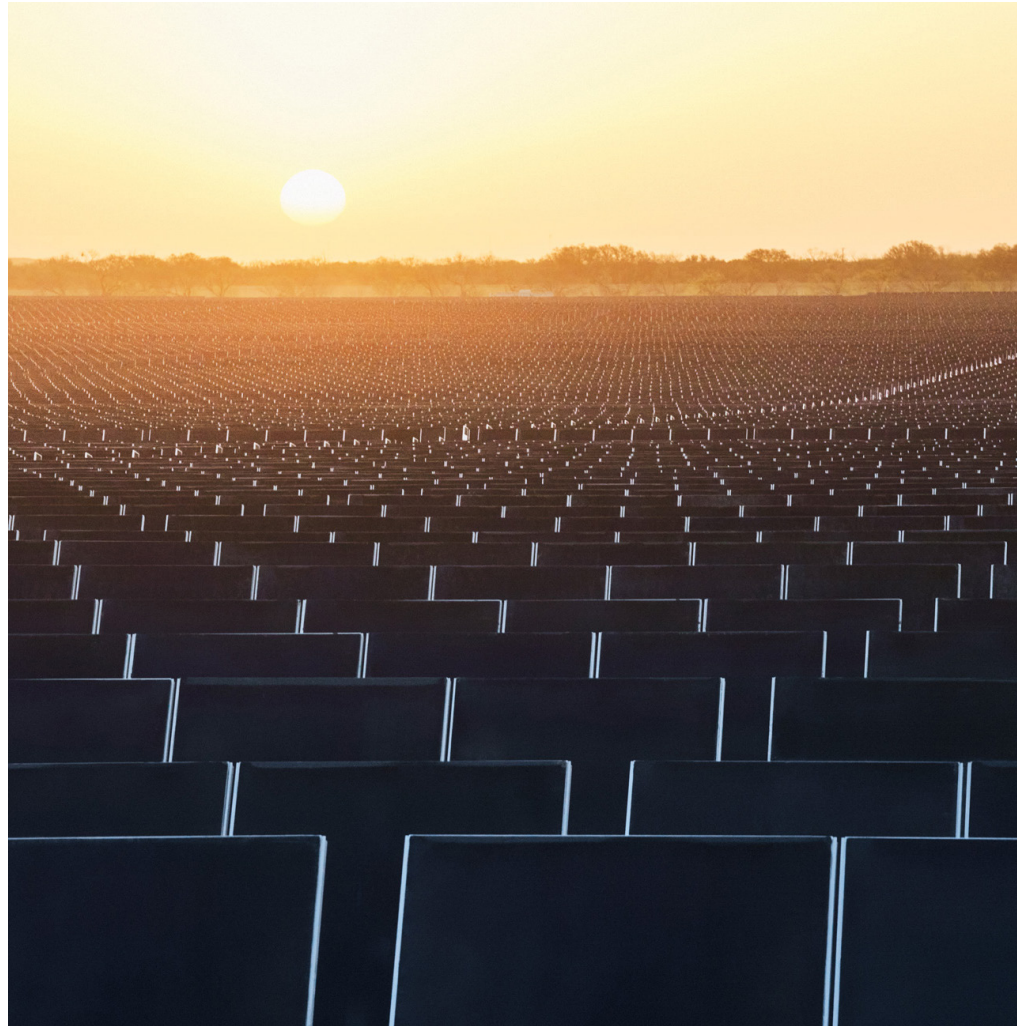
Apple investiert weltweit in erneuerbare Energien – einschließlich dieses groß angelegten Solarprojekts in Brown County, Texas – um den Stromverbrauch von Kund:innen beim Aufladen ihrer Apple Geräte zu senken.
