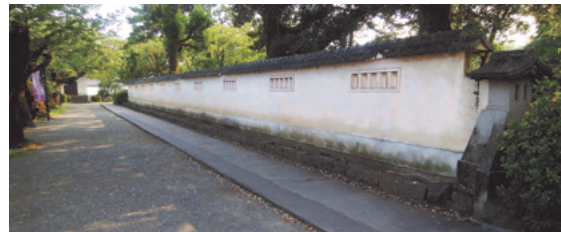
写真 8-11 二の丸に残る旧城内小学校の塀（強度の問題から改良事業の対象となっている）
