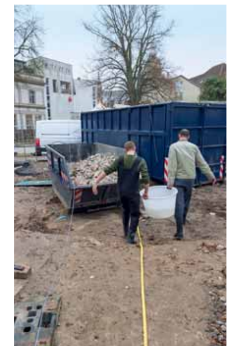
Beim Abbruch der alten Aquarientechnik und Beckenanlagen packen die Aquarianer tatkräftig mit an.
