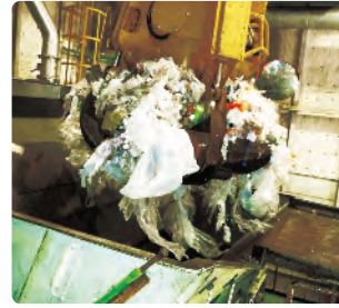
処理設備：供給クレーン
