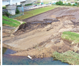
②-1 被災状況
