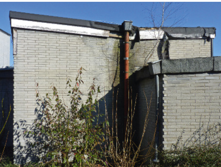
10 Schäden am Dachaufbau. 2011.
