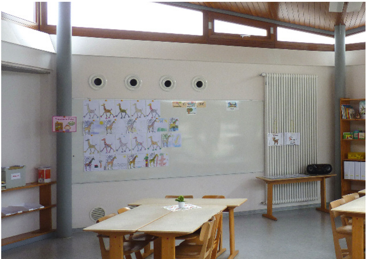
16 Belüftungsdüsen und Heizung im Klassenraum. 2016.
