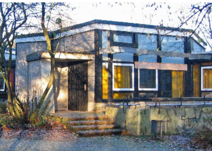
11 Schäden an Fenstern, am Sonnenschutz und am Dach. 2004.
