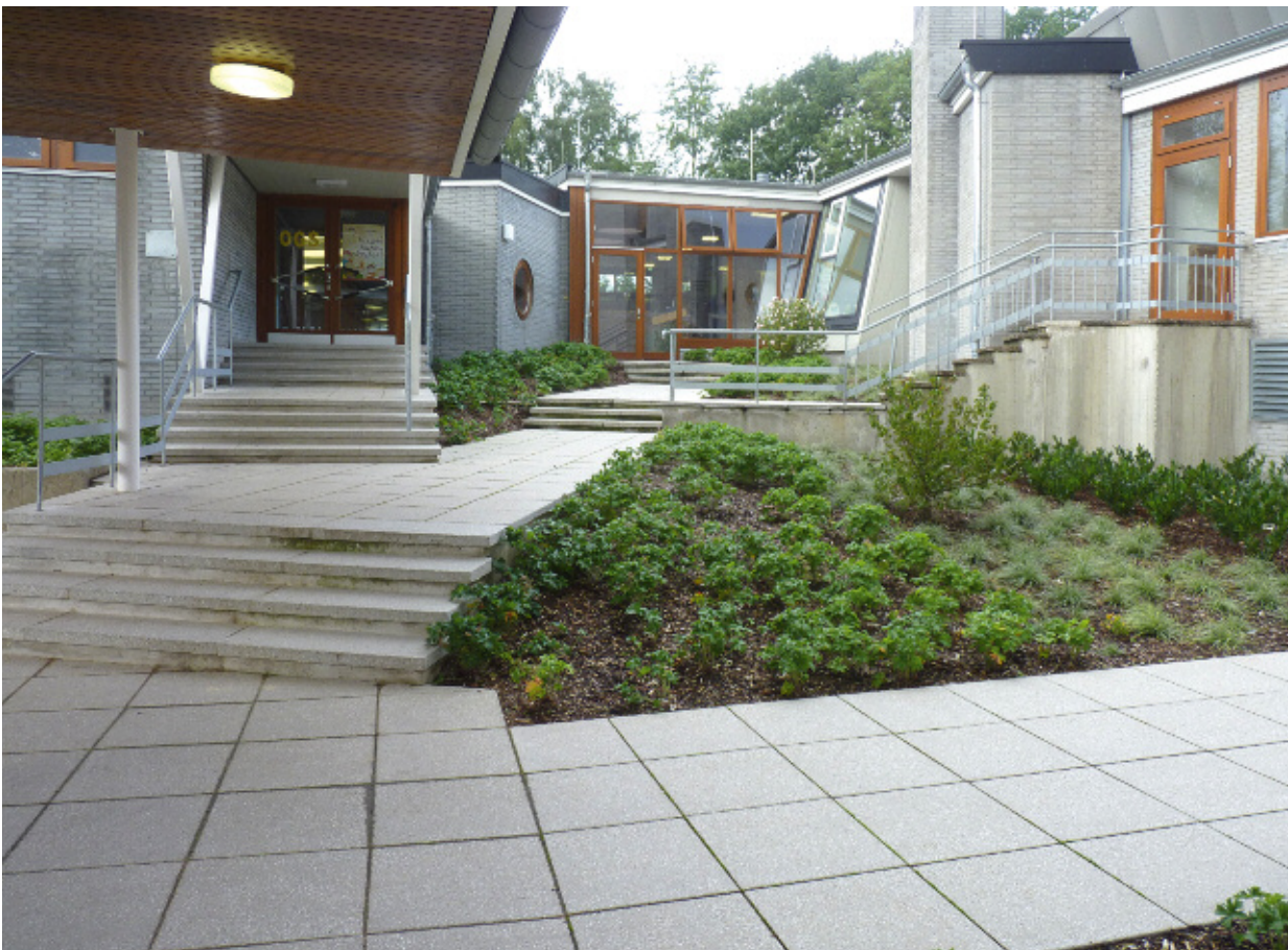
18 Waschbetonersatzplatten im Bereich des Ganztagsbetriebs. 2015.
