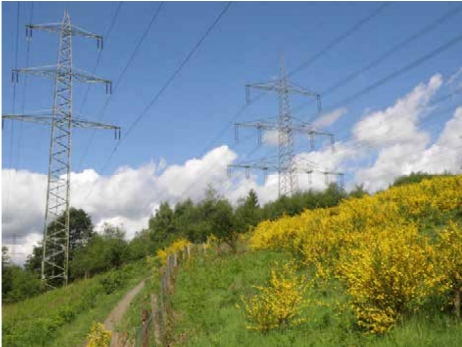
Abb. 3: Hochspannungs-Freileitungen, Büsche und Ginster (18.5.2009).
