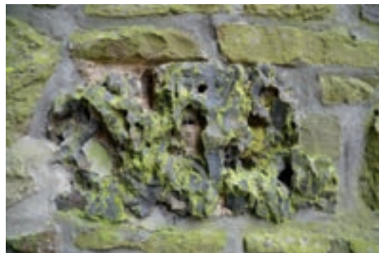
Abb. 33a, 33b: „Würmeriges Gestein“, Nordwest-Bereich des Turmes
