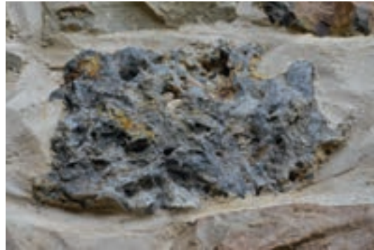
Abb. 32a: „Würmeriges Gestein“: Vereinzelt am Beginn des Kirchenschiffs an der Südwestseite
