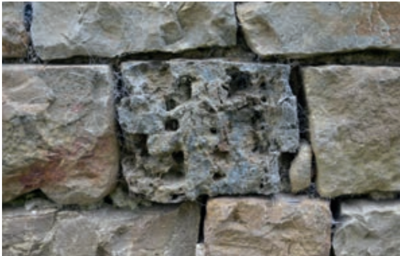
Abb. 6: Würmeriges Gestein in der Südwand der Alten Kirche
