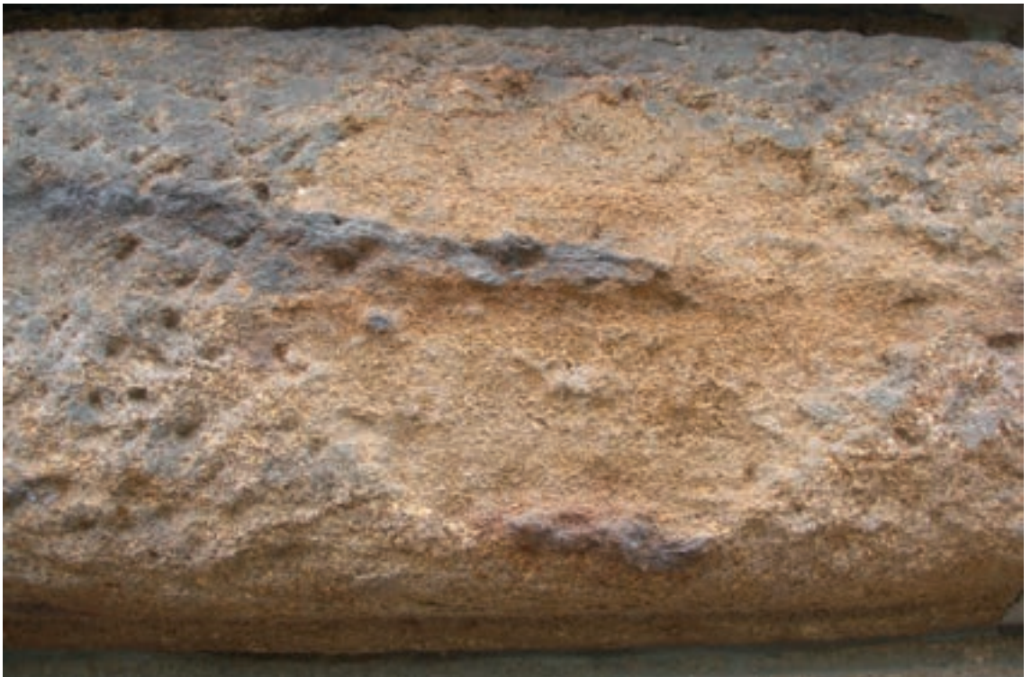
Abb. 11: Flächiger Verlust der Oberfläche durch Absanden infolge Bindemittelverlust bzw. Absanden nach Verlust der Kruste an der Oberpostdirektion in Hamburg (Foto Ebel)
