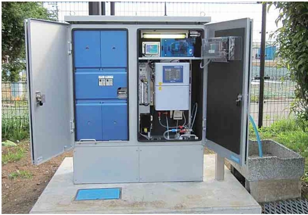
図-2 自動水質計器(右:計測器、左:非常用電源)
