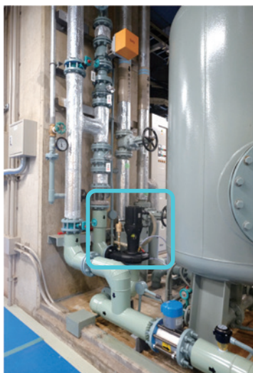
マイクロ水力発電 冷却水循環水による発電事例
