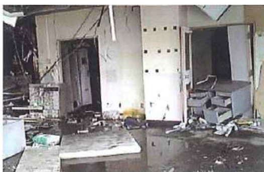
仙台港営業所事務所内
