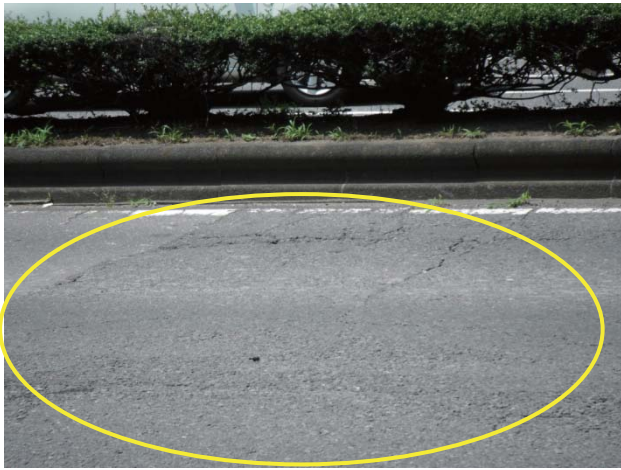
図-13 南向き40m～50m付近の路面状況
