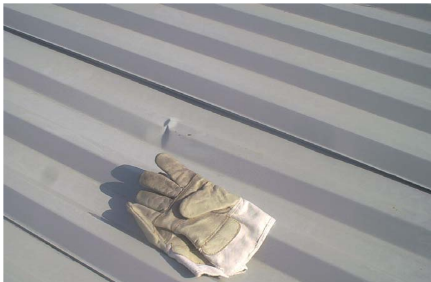
Offensichtlich nicht begehbares Dach eines Sprinklertanks begangen von P. Knödel am 12.03.05.
