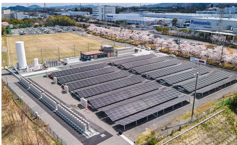
写真 2. 工場の自然エネルギー100%化に向けた実証施設「H2 KIBOU FIELD」(滋賀県草津市)
