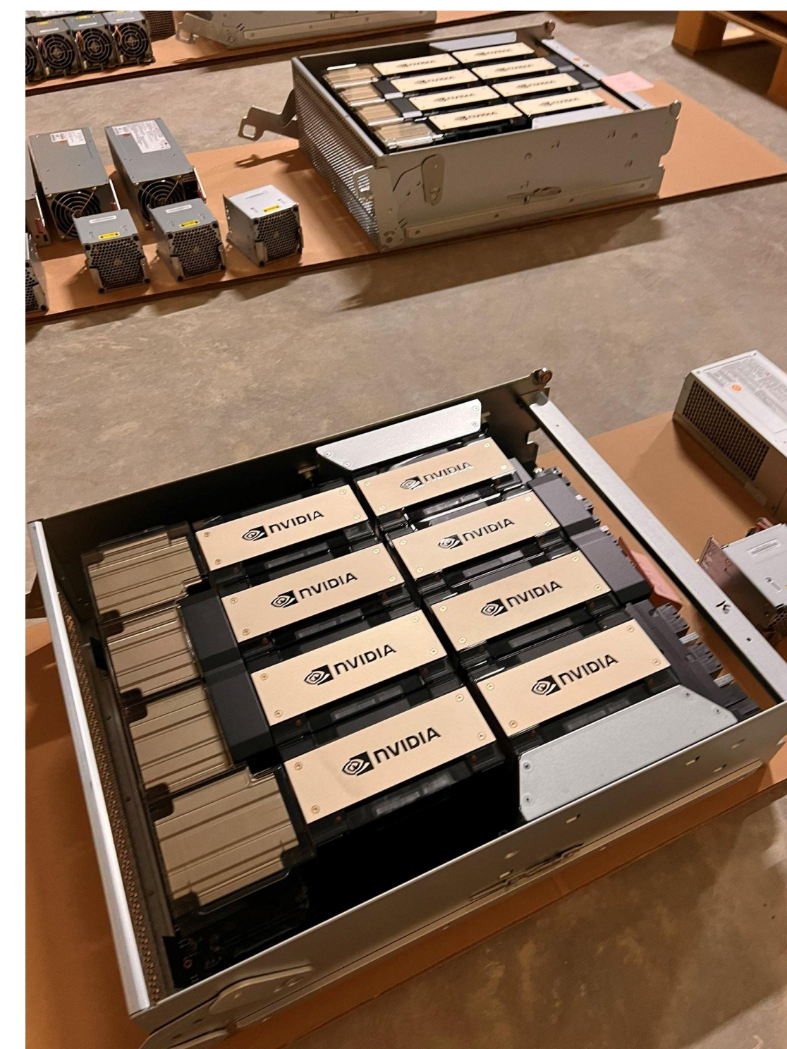
▲2023年10月 石狩データセンターでのGPUサーバセットアップの様子
