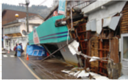
新潟県中越地震で半壊した商店
