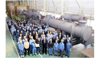
サウジアラビア向けターボ冷凍機
