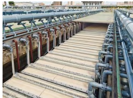
水処理プラント
