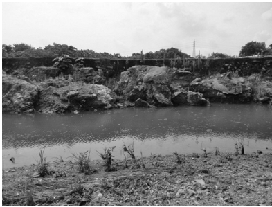
昨年7月12日の大雨による堤防の崩落（鳩川・越辺川合流域）
