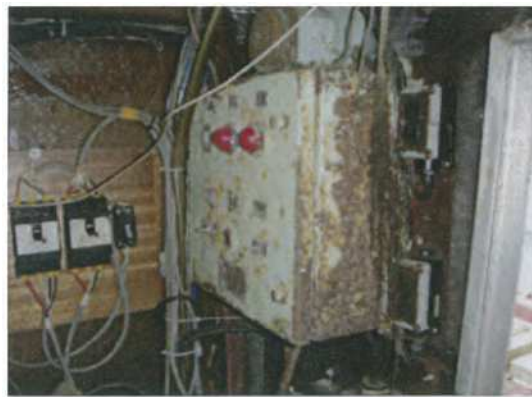
電装機器の腐食
